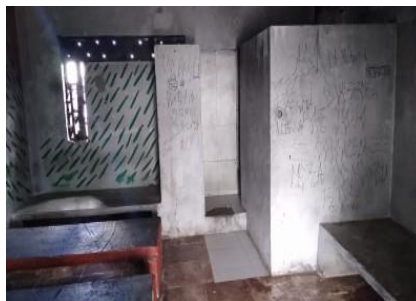
Alojamiento, estado actual de camastros y espacio para baño.
