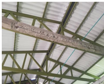
Estructura metálica, con apoyos sobre vigas en mal estado
