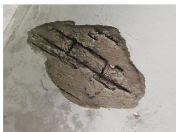
Placa en mal estado, se encuentran varillas oxidadas.
