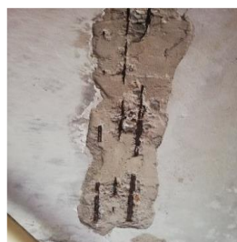
Perdida de recubrimiento y varillas lisas Oxidadas.
