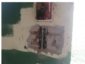
No se encuentra columna , resultado ser un machón en mampostería.
