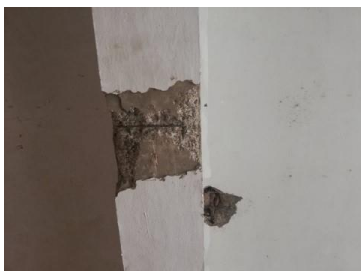
Viga de amarre de 35 x 50 recubrimiento en mal estado, se encuentran varillas oxidadas .
