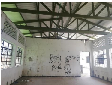
Estructura metálica, con apoyos sobre vigas en mal estado y machones en mampostería
